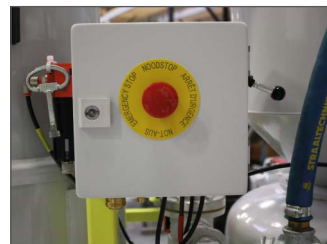
Pneumatisches Kontrollsystem mit Anti-Statik-Verkabelung
